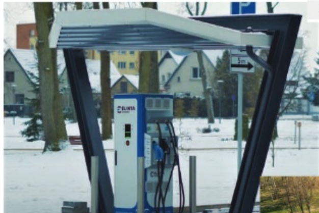
Įrengtos dvi elektromobilių įkrovimo stotelės
